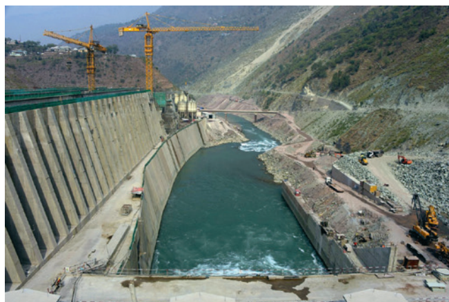
Das von China gebaute Neelum-Jhelum-Wasserkraftwerksprojekt in Nosari, Pakistan, hier im Jahr 2017, wurde 2022 stillgelegt, weil die Behörden schwerwiegende Risse entdeckt hatten.
