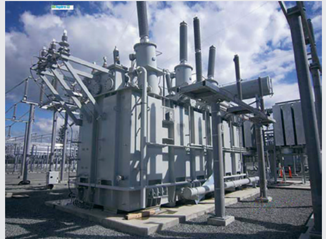
Transformatoren der chinesischen Firma JiangSu HuaPeng, die bereits hundertfach in den USA installiert sind.
