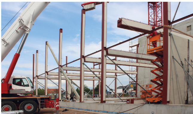
Abb. 4.16: Montage kammerbetonierter Verbundstützen und -träger für das Labor- und Lagergebäude I14 | Biotest Pharma GmbH | Dreieich
